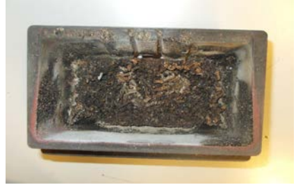
BEISPIEL VERSCHMUTZTE BRENNSCHALE
